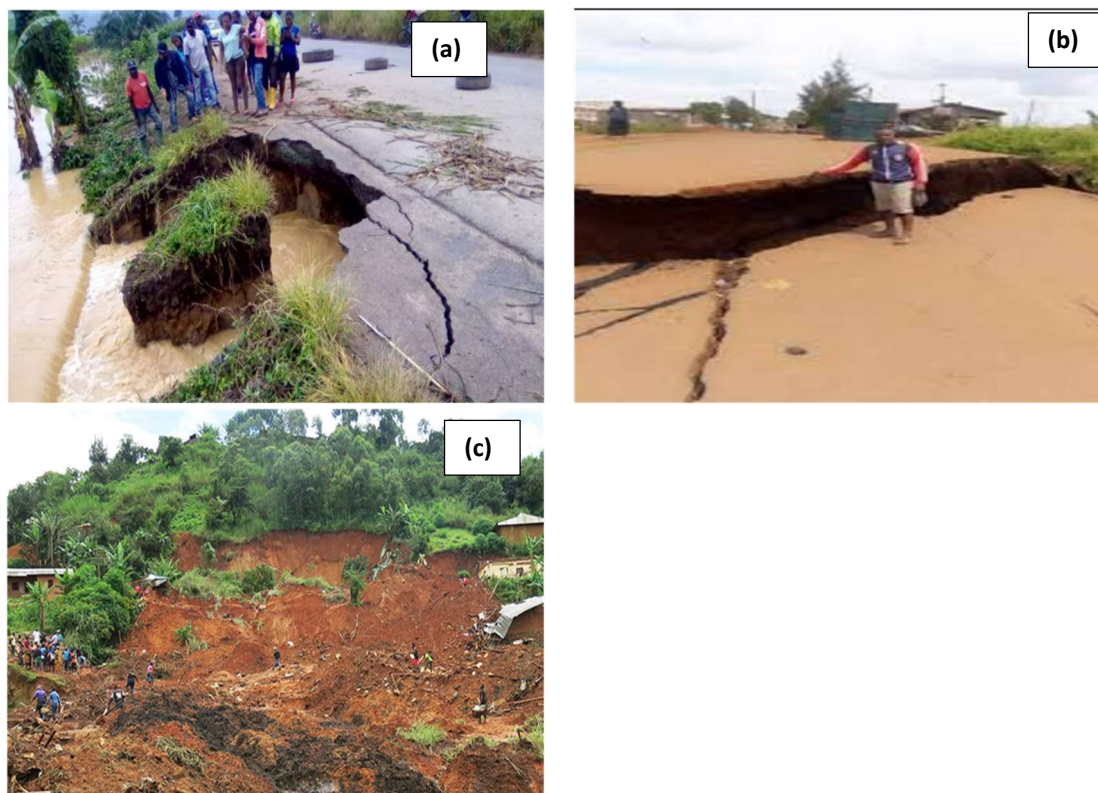
Figure 2 : dégradation des routes (a et b) et glissements de terrains dans la Région du l'Ouest
