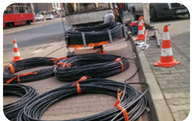
• Déploiement fibre optique autour du périmètre national et dans l'hinterland (Plus 18 000 Km)
